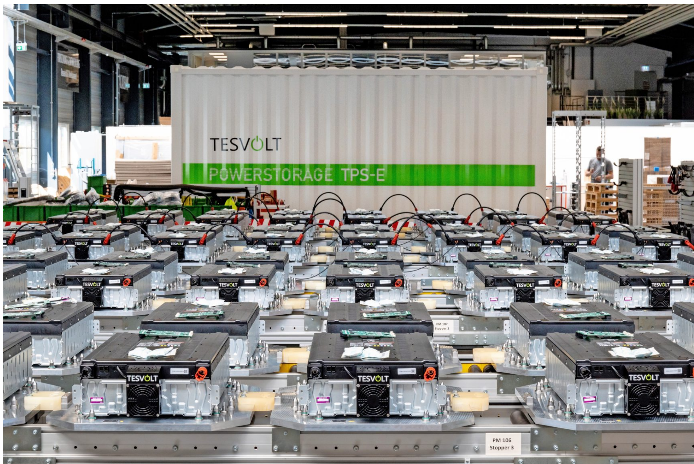
Die Batteriesysteme von Tesvolt können schon mal einen ganzen Container benötigen. Im Vordergrund ist die Zyklierungsstrecke mit Batteriemodulen zu sehen.
